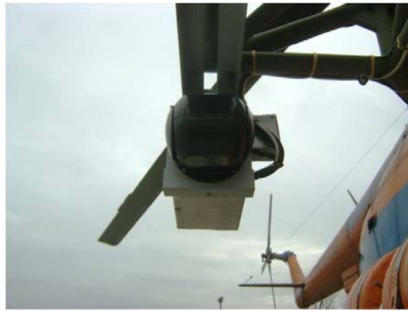
Рис. 3. СМС ТСКВ, установленный на кронштейне
